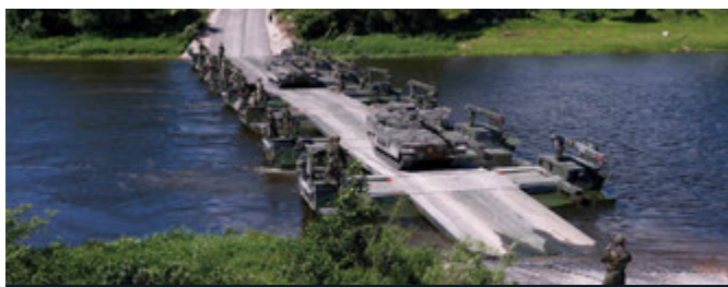
Brittiska och tyska förband byggde under en övning en 350 meter lång bro på 35 minuter, med ett sådant system som Försvarsmakten får om två år.
